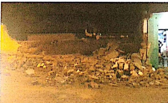
FRENTE DA ESCOLA COM PARTES DO MURO EM RUINAS
