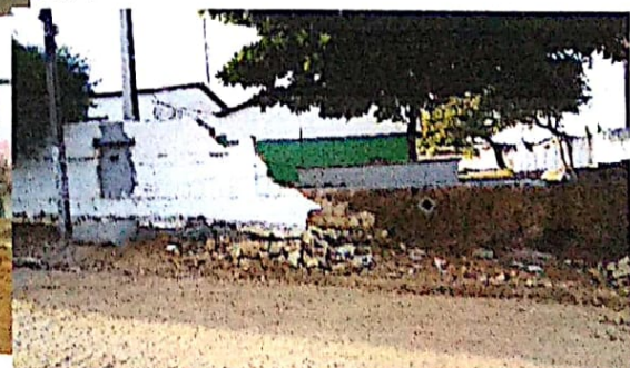
FRENTE DA ESCOLA COM PARTES DO MURO EM RUINAS
