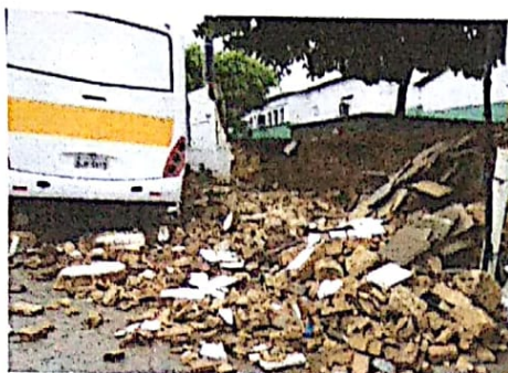
FRENTE DA ESCOLA COM PARTES DO MURO EM RUINAS
