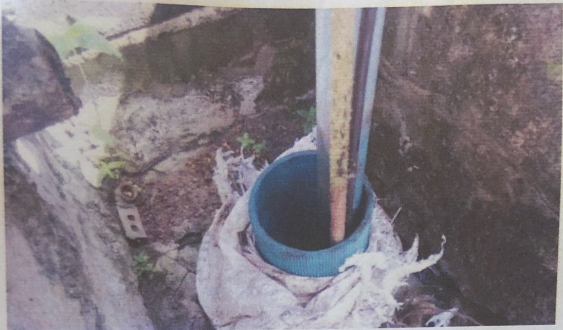
Figura 7 – Tubulação do poço e da bomba (foto de abril de 2019).
