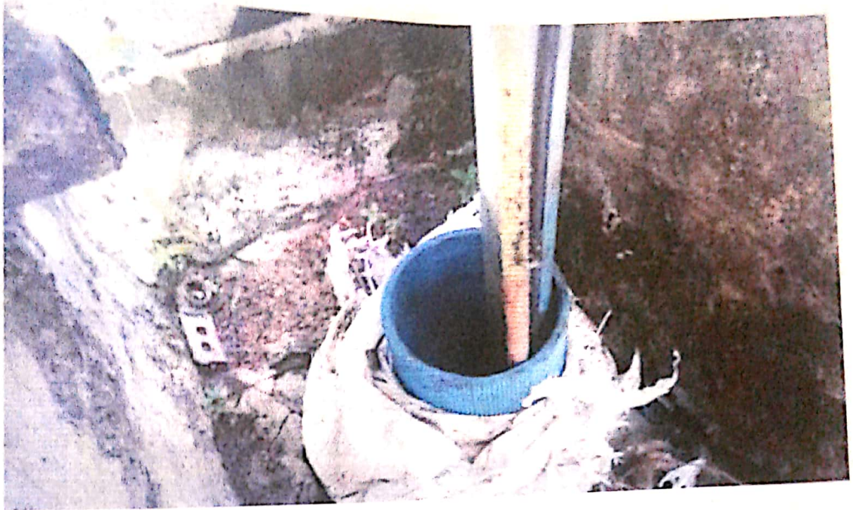
Figura 7 – Tubulação do poço e da bomba (foto de abril de 2019).
