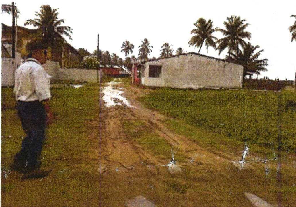
Via local de acesso onde foi seccionado o terreno em sua extensão longitudinal
