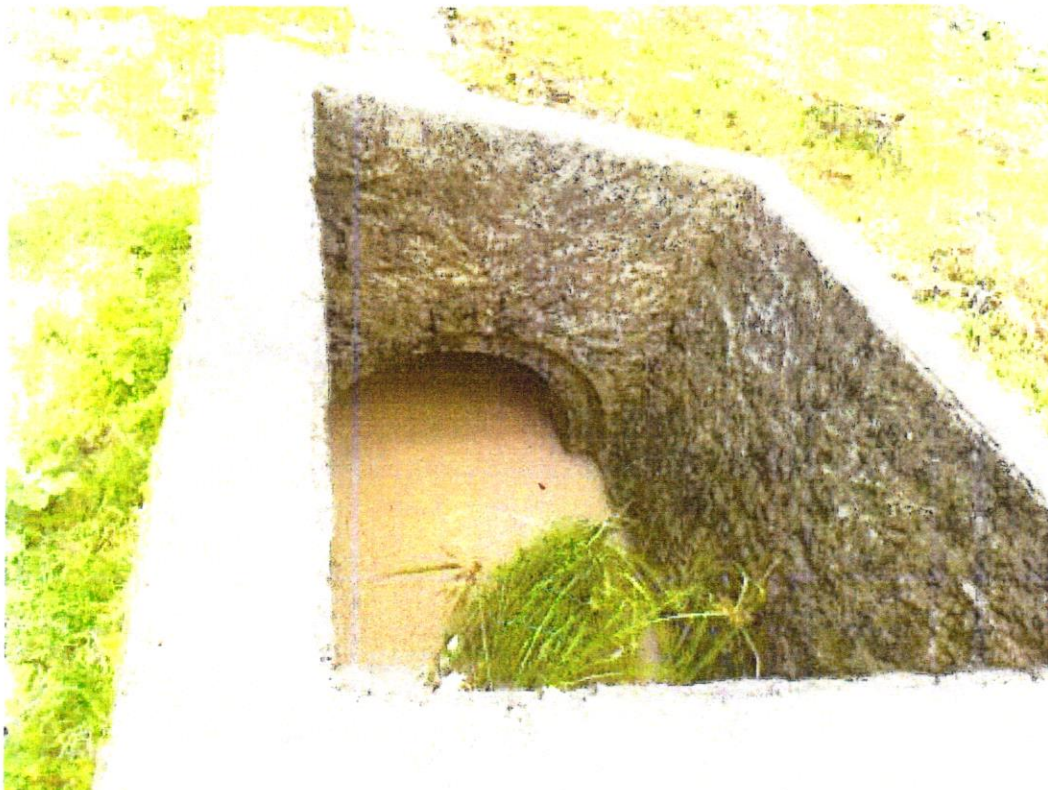
Caixa de passagem das águas pluviais locada na área do terreno em sua extensão longitudinal, sentido lagoa.
