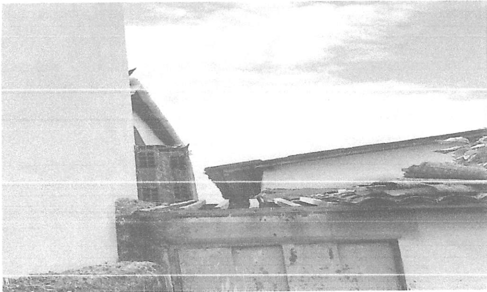
Foto 7 – Destelhamento irregular na residência da denunciante.
