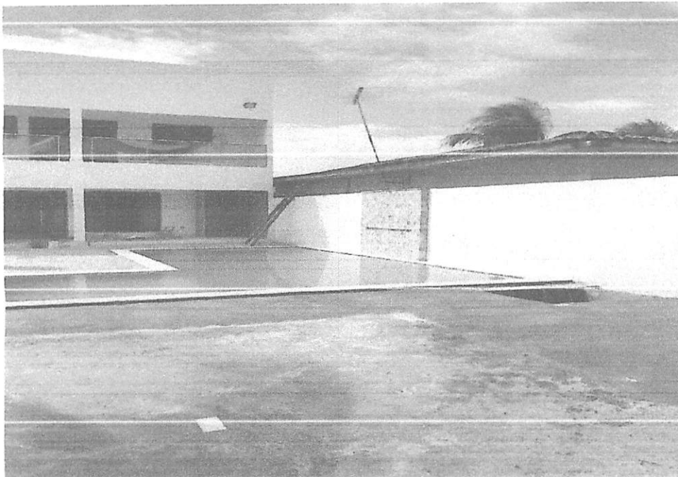
Foto 1- À direita fachada do prédio invasor, edificação excede a altura de 3,5m.
