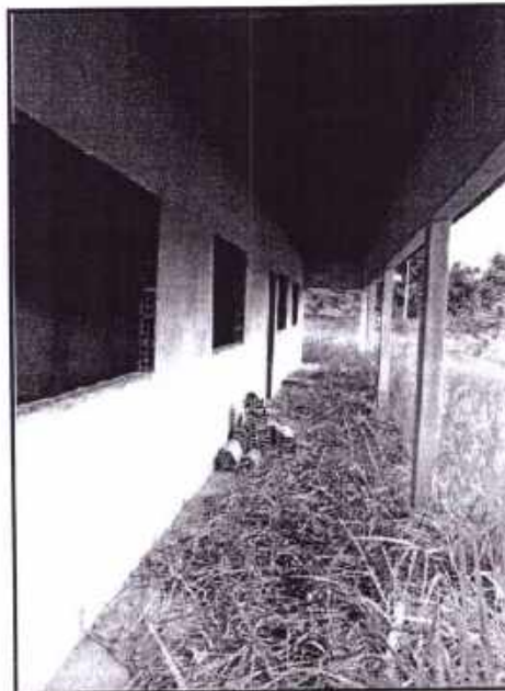
Figura 12 – Foto da Circulação confirma o abandono da obra não contendo forro, esquadrias, vidros, piso e inclusive a falta de limpeza e organização do canteiro de obras.
