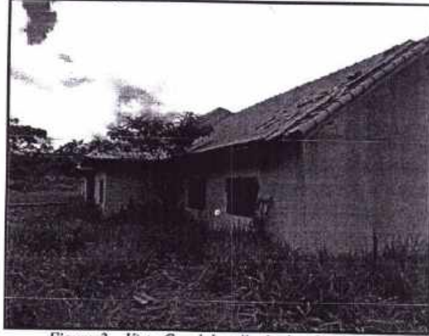
Figura 3 – Vista Geral do telhado danificado por.
