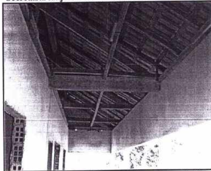
Figura 11 – Foto da Circulação sem instalações de forro de PVC.
