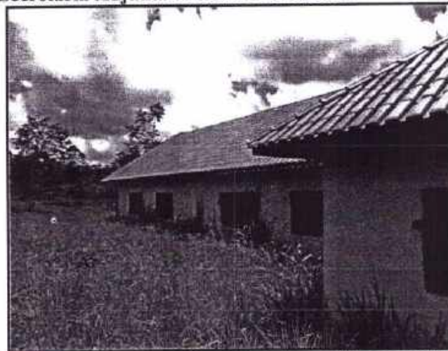
Figura 7 - Foto demonstra a não existência de esquadrias na construção.
