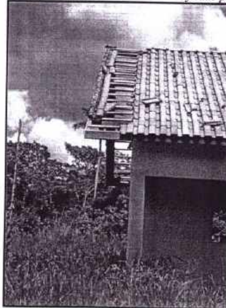
Figura 4 – Vista frontal do telhado com beiral danificado devido imperfeição na instalação, sofrendo ação de chuvas e ventos.
